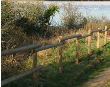
La modification de la gestion agricole au dessus de la falaise de l'Hôtellerie devrait ralentir les effondrements de la falaise.
