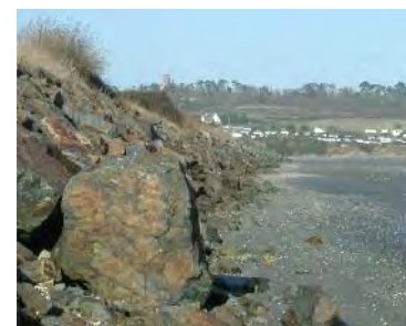
La digue de la décharge de la grève des Courses est perméable aux polluants qui migraient vers la mer.
